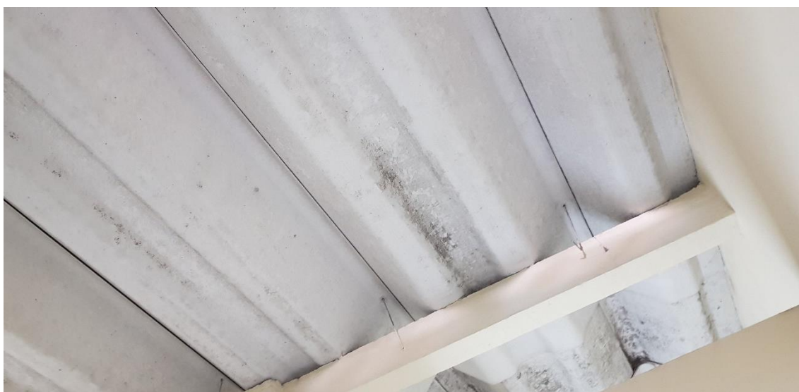
Foto 15 – Telas em Fibrocimento Antigas (com amianto) a serem Trocadas.
