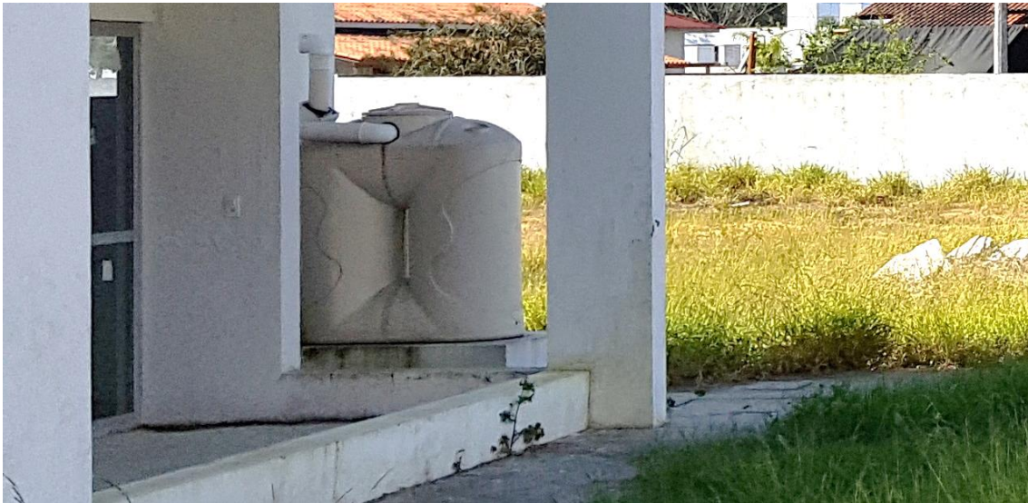
Foto 10 – Sistema de Captação de Água da Chuva Já Instalado – NEIM Red Park
