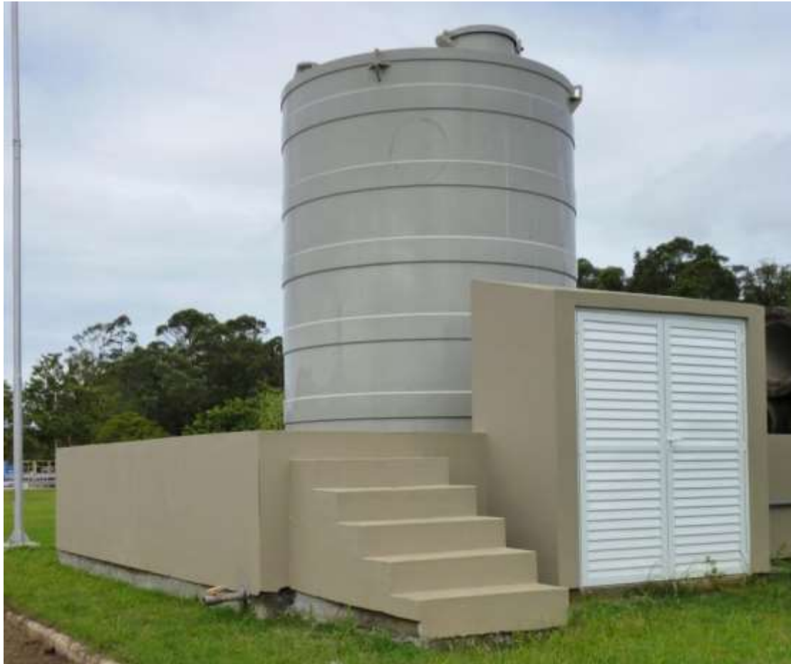
Instalação do sistema de dosagem de coagulante - ETE Canasvieiras
